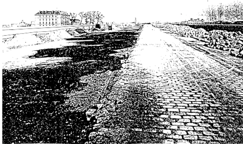
Vue du travail de la normalisation - mise à niveau, alignement, et dans l'entre-deux-guerres percement de passages souterrains - du boulevard Sérurier dans le 19 e arrondissement . De tels aménagements ont été réalisés au nord du 18 e arrondissement, boulevard Ney.
